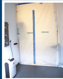
ASSAINISSEMENT DEGATS D'EAU Cabinet médical
